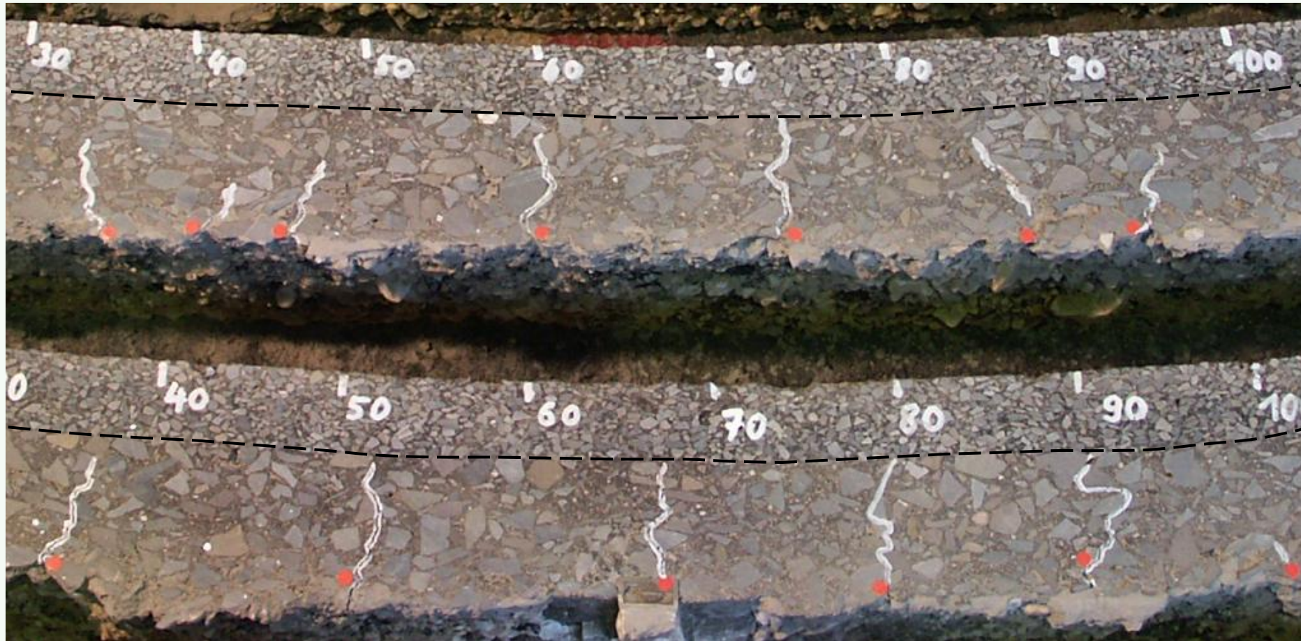
Rissbildung in der AT nur bis zur Schichtgrenze AD-AT
